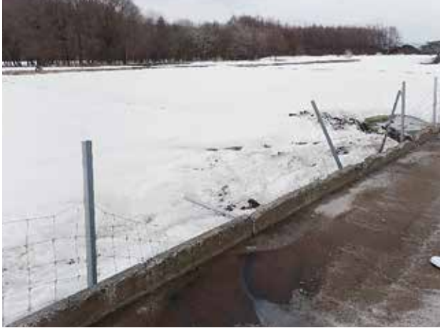
壊れた外周フェンス
